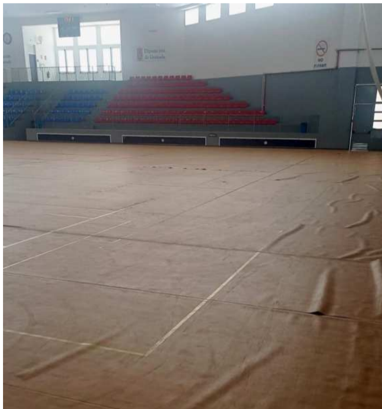
Estado del pavimento del pabellón cubierto. DIPGRA
