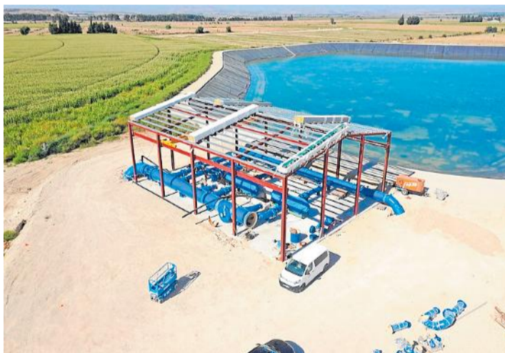
Infraestructura de riego en el Canal de Monegros. Albaida
