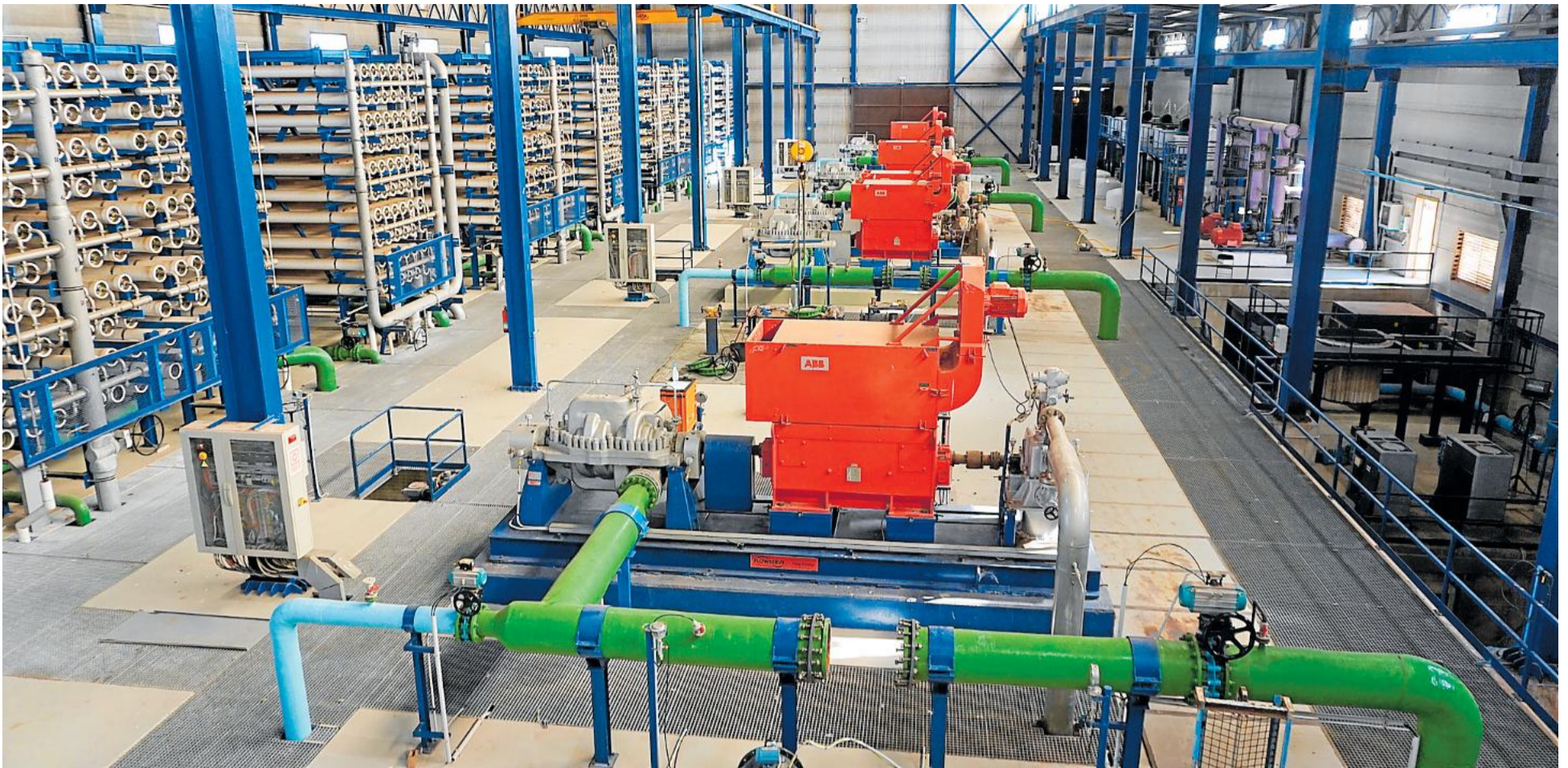
Nave de proceso interior de la IDAM Mar de Alborán. Aqualia
